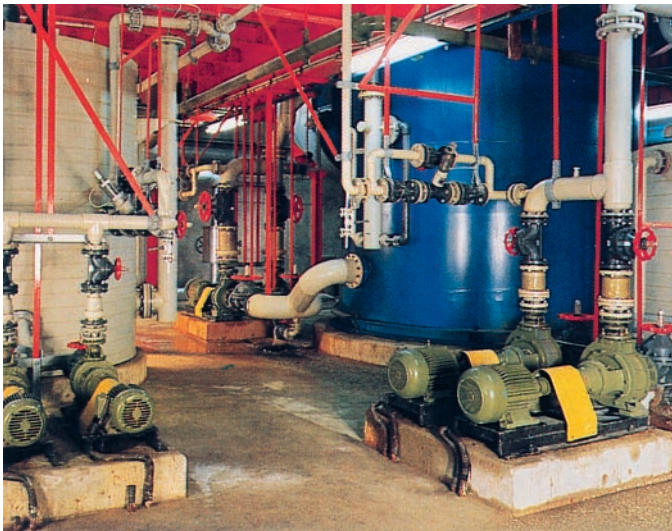
CPDR-Pumpen in der Müll- und Klärschlammverbrennung (Calciumchlorid-Lösung mit Feststoffanteilen)
